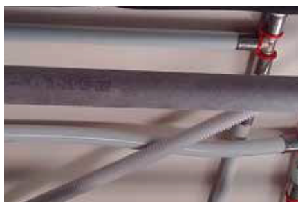
installations sanitaires avec tube multicouche.
