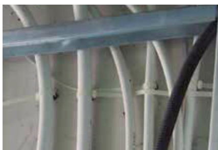
Installations sanitaires avec tuyau PVC flexible.
