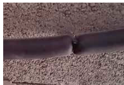
Installations de climatisation avec isolant.
