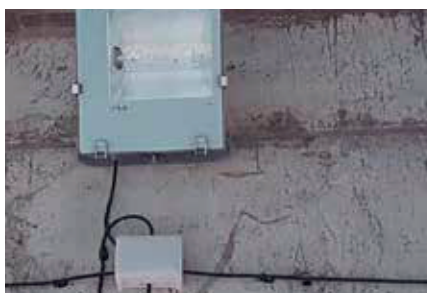
Installations temporaires de câblage.
