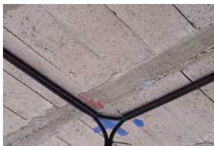
installations électriques avec gaine flexible.
