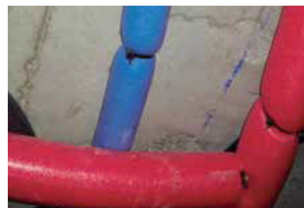
Installations sanitaires avec tuyau PEX isolé.
