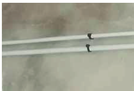
installations électriques apparentes avec tube PVC rigide.
